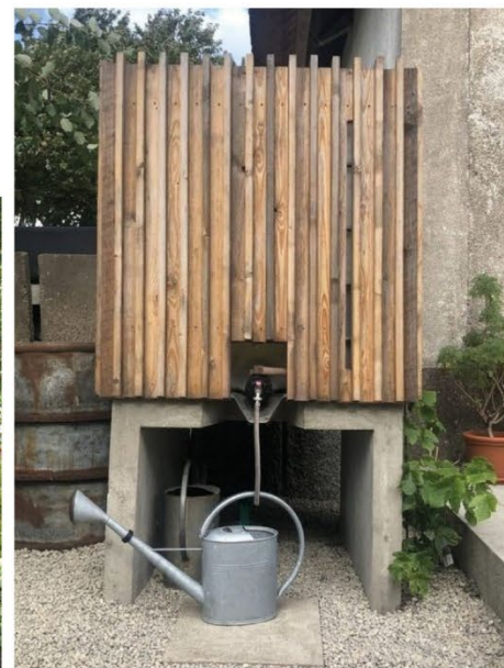
la citerne d'eau de pluie
